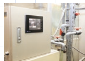
かんすい調合制御盤
