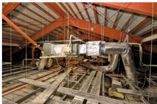
中温空調ダクト
